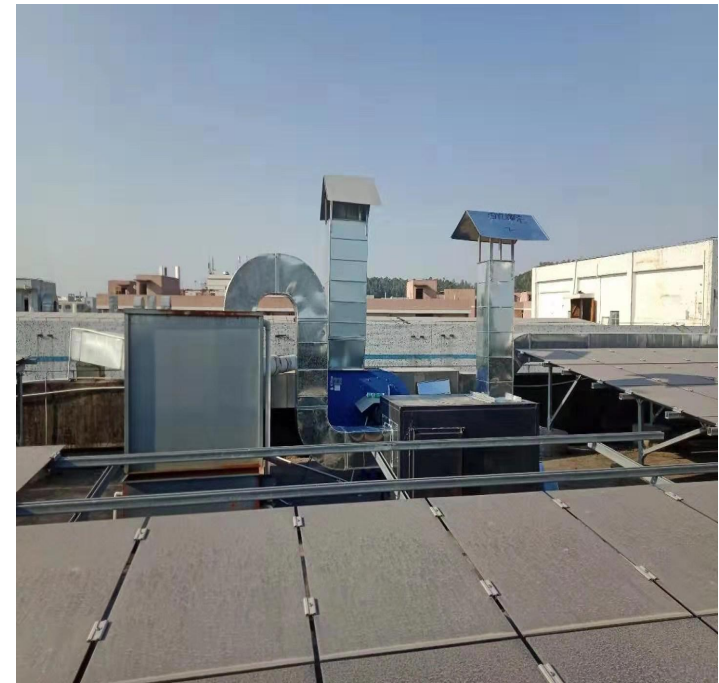
废气处理设施
